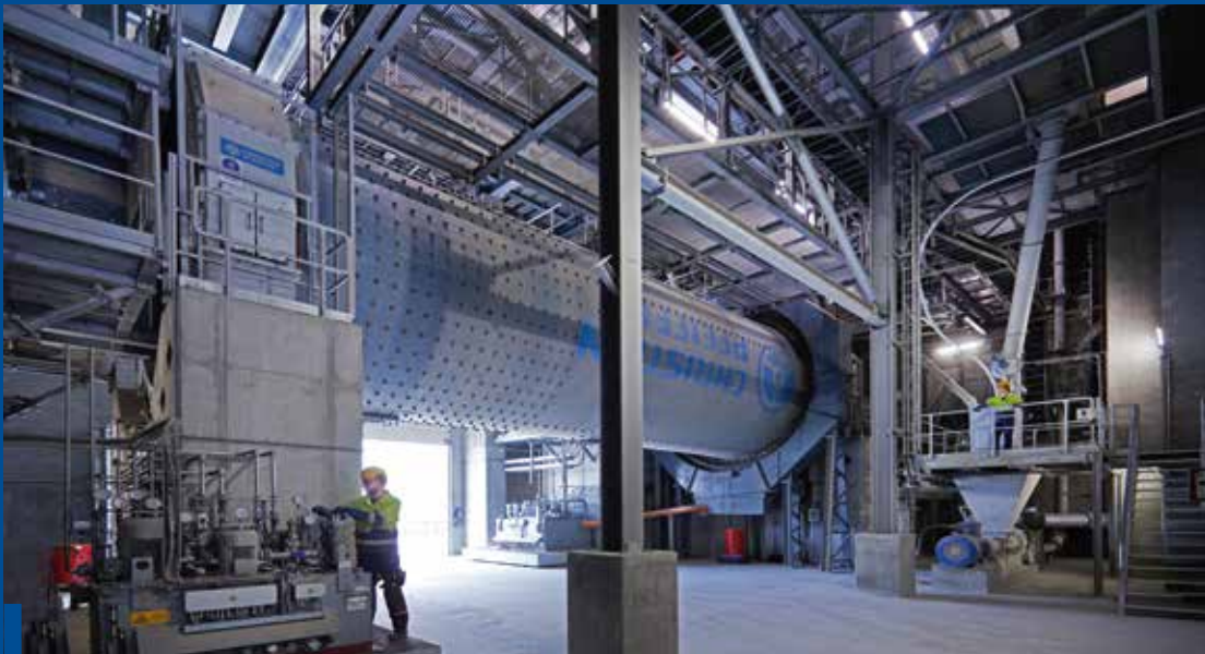
Die neue Zementmühle 11 mit der im Einsatz befindlichen Künstlichen Intelligenz führt zu einer Stromersparnis im zweistelligen Prozentbereich.
